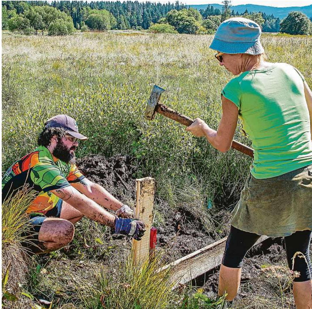
Zatloukání kolíků Součástí mezinárodní skupiny dobrovolníků je i Peter z Bulharska. Na snímku pomáhá při stavění hrázek, které pak zadržují vodu. 2x foto: Petr Lundák, MAFRA
